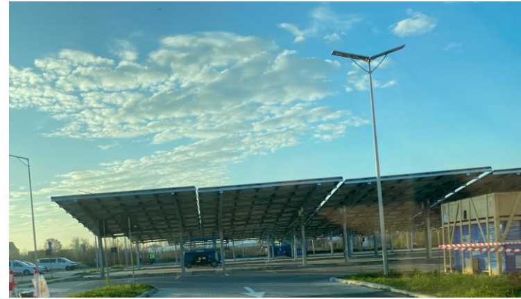
Carport – 0.7 MW PV
